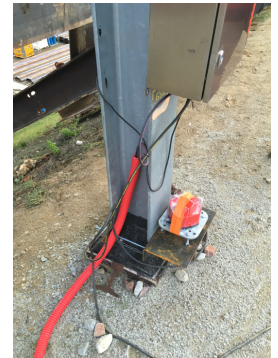
Figure 5. Balise ROCK proche du coffret électrique
